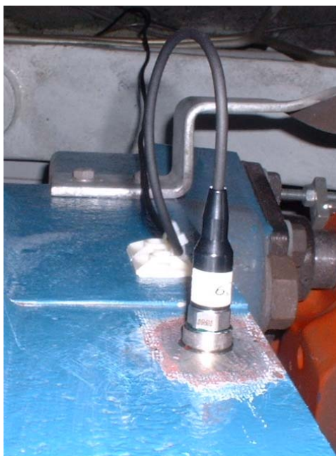
Bild 23: Mittels geklebter Montagebasis befestigter Beschleunigungssensor
